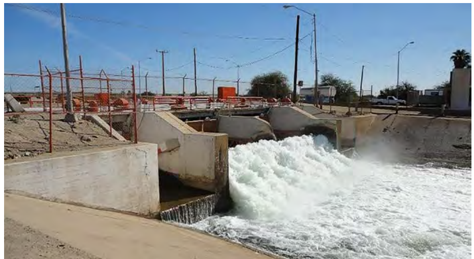
Figura 1. Estructura de control Canal Reforma km 27+000.
