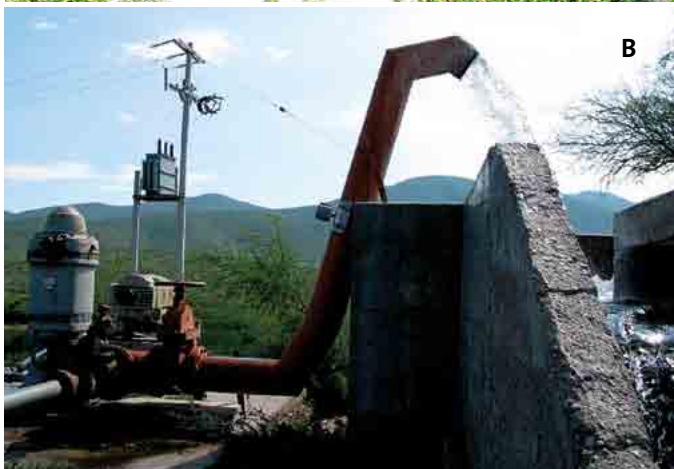
Figura 1. Sistemas de extracción de agua subterránea en el municipio de Tula, Tamaulipas, México. A: noria. B: pozo profundo.
